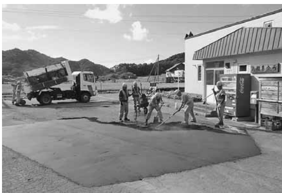
道路工業 株式会社 留萌営業所 様 (大楯集会所前の舗装補修工事を実施)
