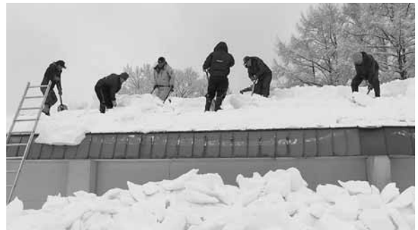
橋場・堀口経常建設共同企業体 様 旧寧楽小学校屋根の雪下ろし作業（2/8）
