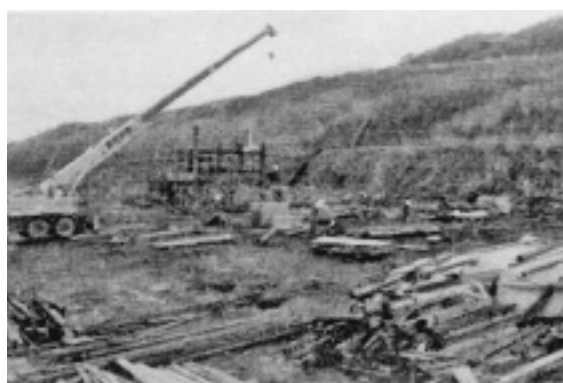
リニューアルを目指し解体修復工事中の 旧花田家番屋 (642号・昭和57年8月号掲載)
